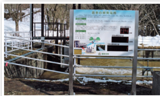
喜多の郷発電所（小水力発電）
