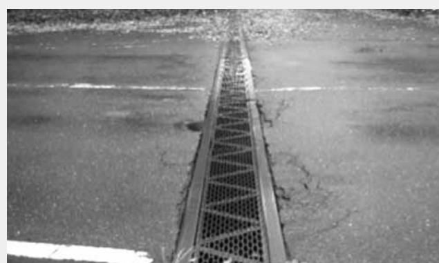
▲段差がある横断側溝(木曾地内)
