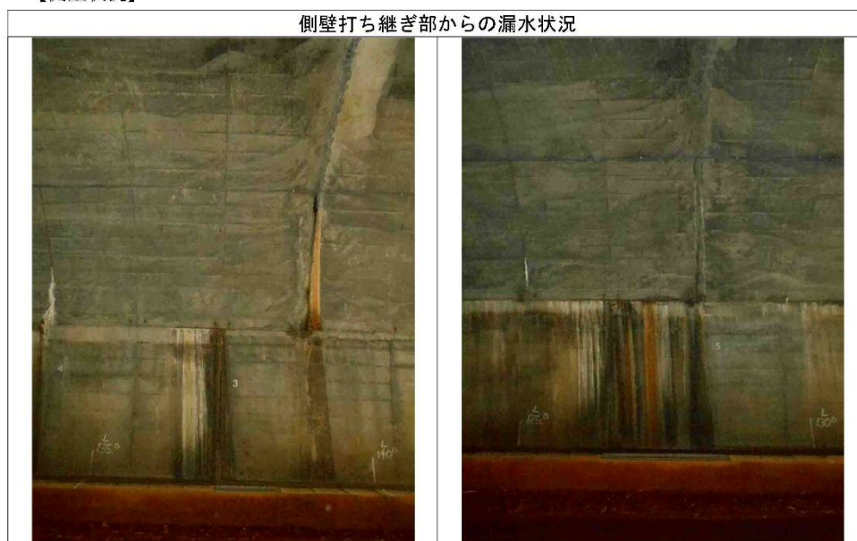
図表 6.2-2 : 現況漏水状況
