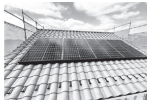
▲ 太陽光パネル
