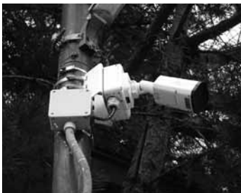
▲設置された防犯カメラ
