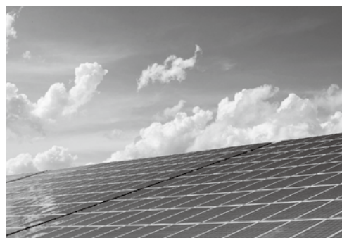
▲太陽光パネル
