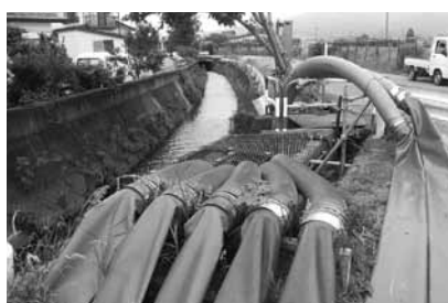
▲増設された排水ポンプ
