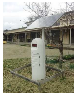
リアルタイム線量測定システム
