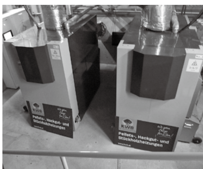
▲木質バイオマスボイラ設置例 (福井県あわら市)
