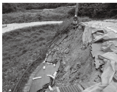
▲高郷町地すべり崩落状況
