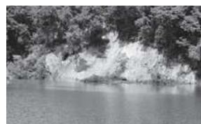
阿賀川の揚津側 崩落箇所
