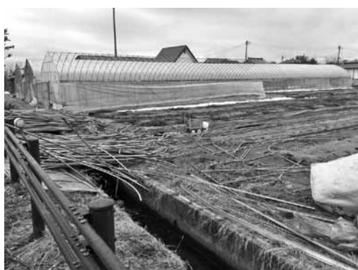
▲倒壊・破損した資材
